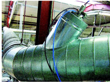
Bild 2: Eindüsanlage im Abluftkanal eines Kunststoff verarbeitenden Betriebes
